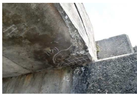
09. 六反橋：RC床版桁 (橋長：2.94m、1975年竣工) 床版下面の剝離、うき ※凍結融解作用により、損傷は進行する。 (迂回路有り)
