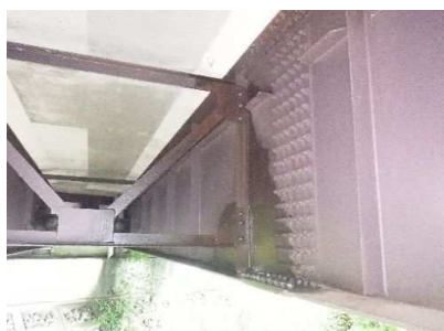
04. 王領橋：鋼I桁橋 (橋長：62.50m、1999年竣工) 床版下面の導水パイプ脱落 ※導水パイプの脱落により、水が桁側面に 飛散する。(迂回路有り) (一部補修済)
