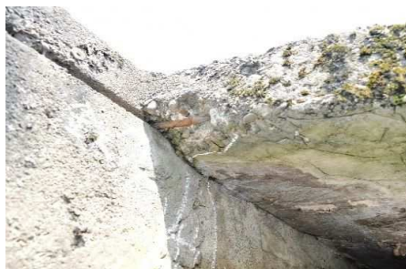
11. 村前北橋：RC床版橋 (橋長：2.10m、1970年竣工) 床版下面の鉄筋露出 ※露出した鉄筋は、腐食が進行する。 (迂回路有り)
