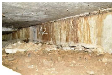
18. 遠背戸橋：RC床版橋 (橋長：4.40m、1983年竣工) 橋台前面の遊離石灰の析出 ※雨水の浸入により、アンカーバーの腐食 が進行する。(迂回路有り)
