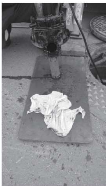
H24.3.8写真はマンホールポンプに からみついたタワです。
