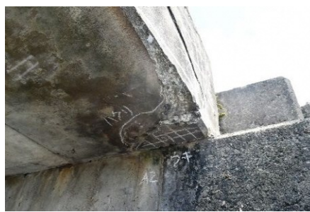
09. 六反橋：RC床版橋 (橋長：2.94m、1975年竣工) 床版下面の剥離、うき ※凍結融解作用により、損傷は進行する。 (迂回路有り)
