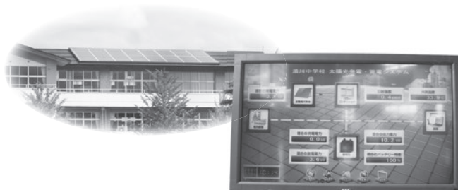
校舎の屋上に設置された太陽光パネルと 制御モニター
